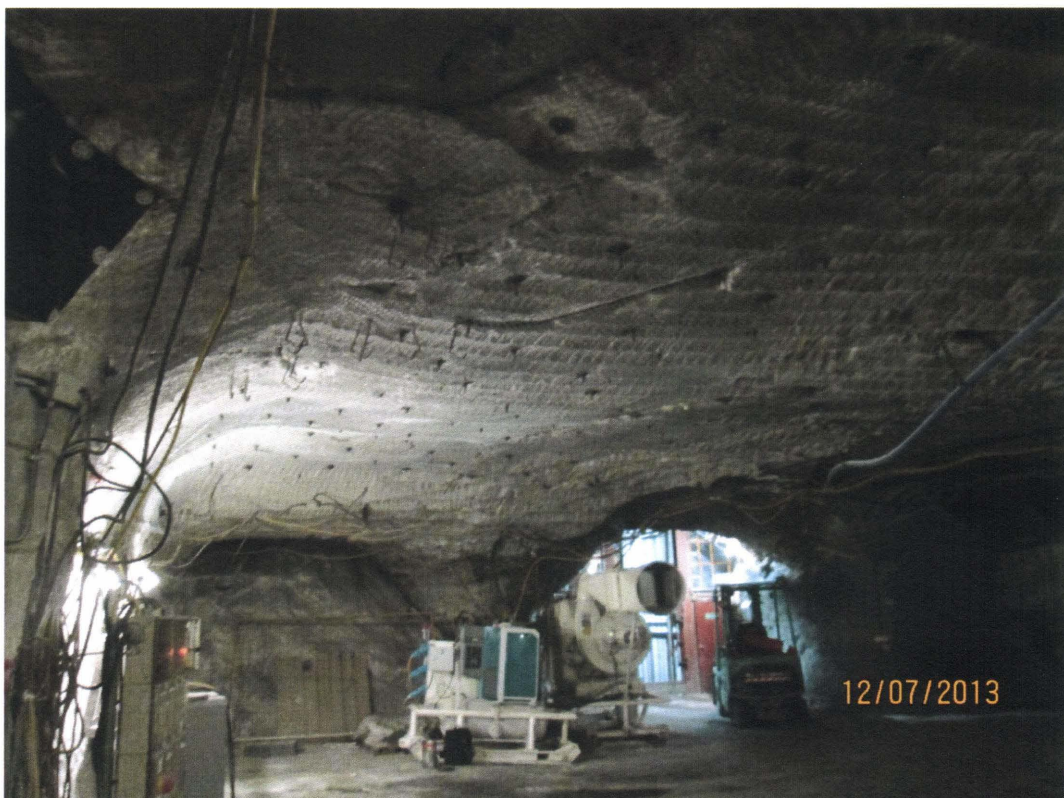
Bild 26: Abschalungen im Bereich westl. Verlängerung der nördlichen Pfeilerumfahrung
