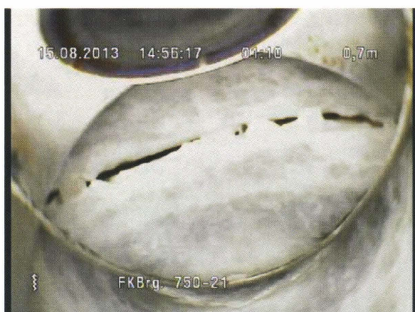
Bild 9: Riss mit ca. 3-4 mm Öffnungsweite (FKBrg. 750-21 – Position ca. 0,66 m)
