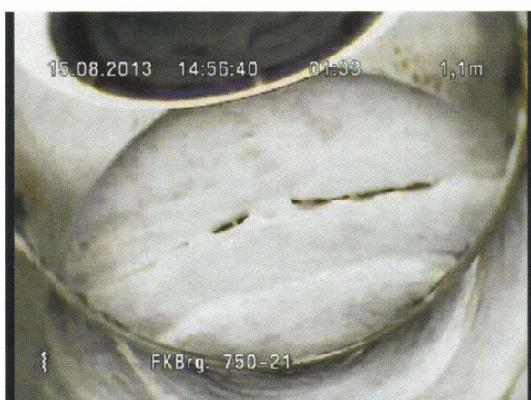
Bild 11: Riss mit ca. 2 mm Öffnungsweite (FKBrg. 750-21 – Position ca. 1,00 m)
