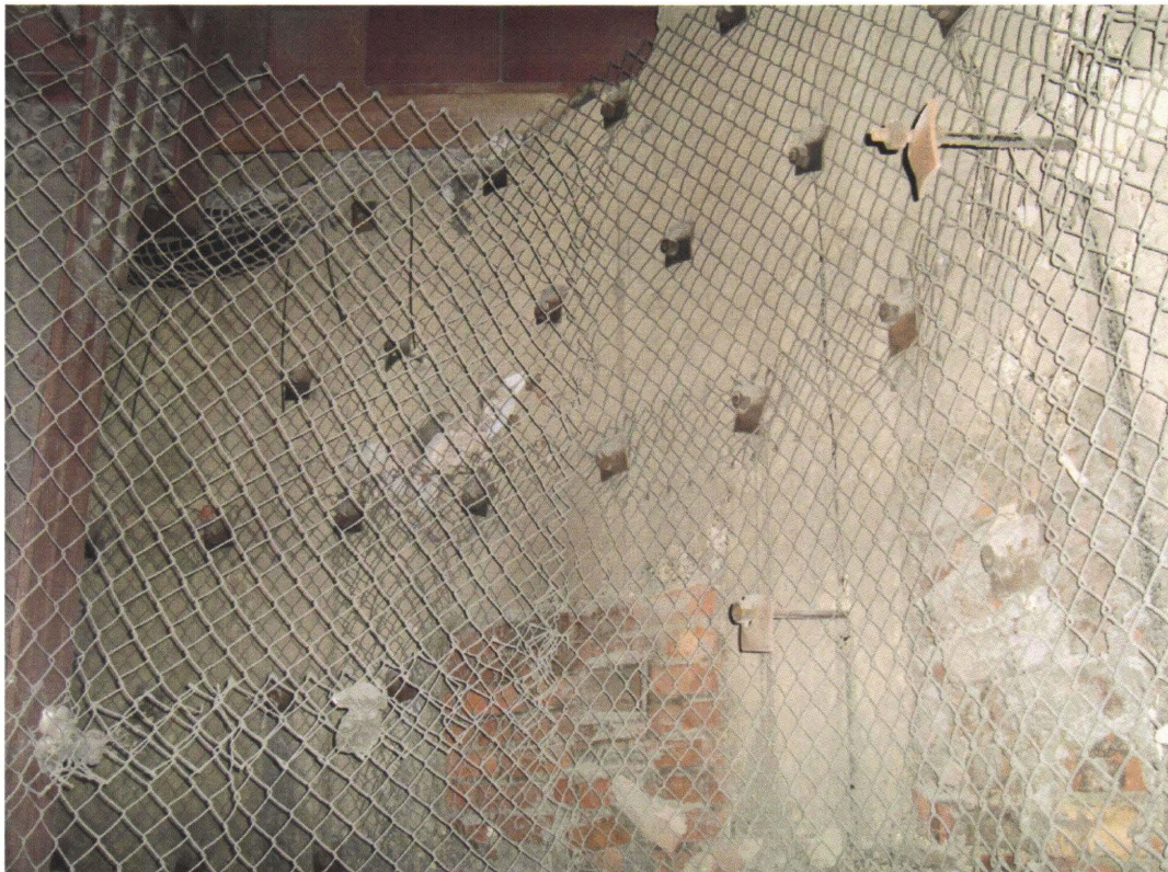
Bild 19: NE'-Schachtausbau, mit Maschendrahtverzug und teils defekter Ankerung
