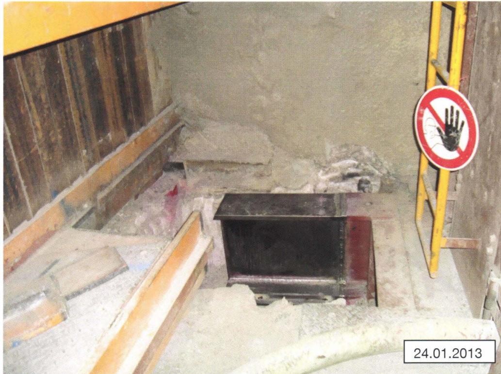
Bild 17: Bessere Einbindung ins Salz durch Trägerverlängerung, SW-Ecke der Schachtabdeckung
